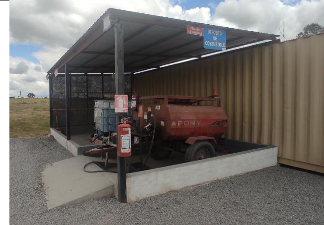
Figura 2 – Depósito de combustible sobre superficie de hormigón, techado y con contención de derrames.
