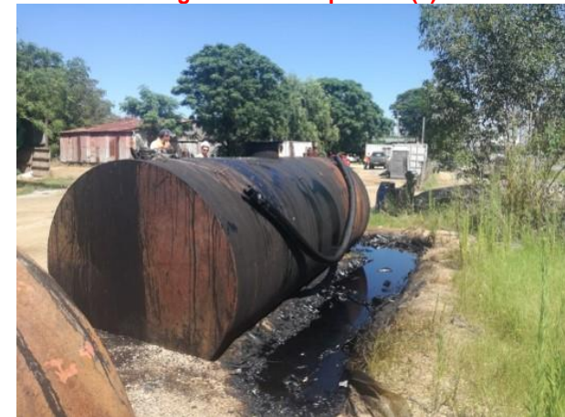
Figura 6 – Tanque semienterrado con canaleta lateral que no puede asegurar la estanqueidad e infiltración del contenido.
