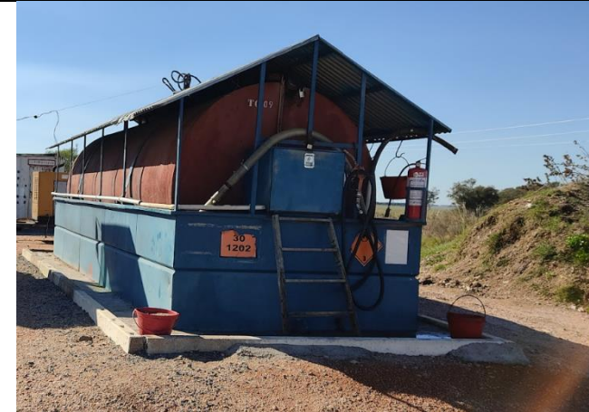
Figura 6 – Tanque de combustible con dique de contención y techo a dos aguas.
