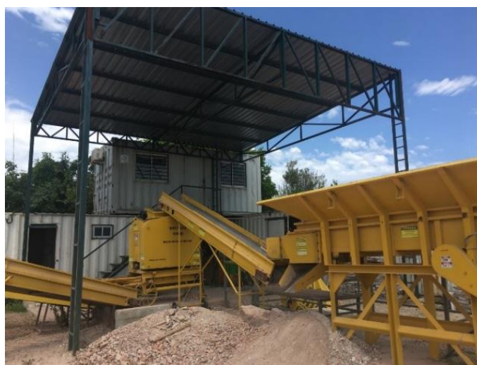
Figura 3-7. Planta trituradora de RCD RECICLAJE (extraído de la Consultoría BID – IM).
