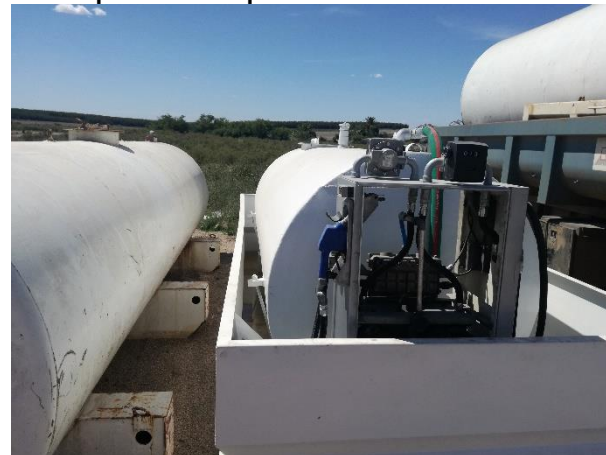
Figura 3 – Tanque de combustible con su correspondiente dique de contención de derrames.
