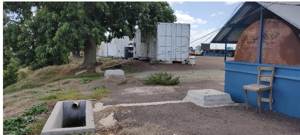
Figura 7 – Tanque de combustible en las mismas condiciones que en la Figura 6, con descarga hacia interceptor de grasas y aceites.
