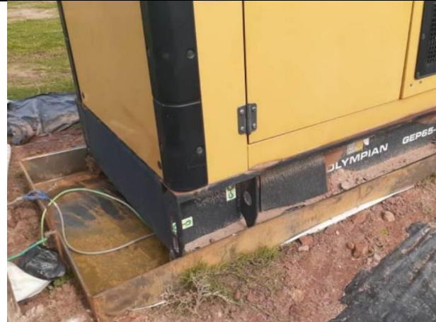
Figura 5 – Generador colocado sobre bandeja de contención estanca.
