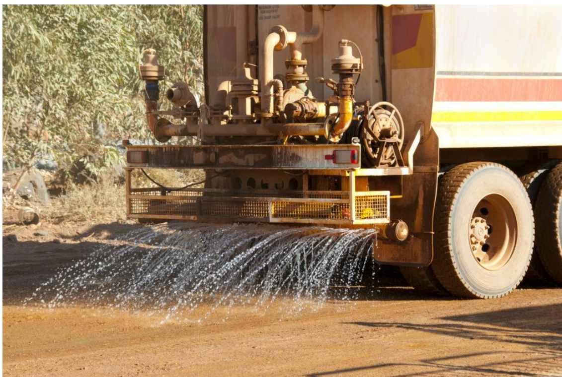
Figura 3-39. Camión regador humedeciendo superficie a fin de evitar las emisiones por rodadura (extraído de https://meteosim.com/medidas-mitigacion-entornos-mineros/ ).
