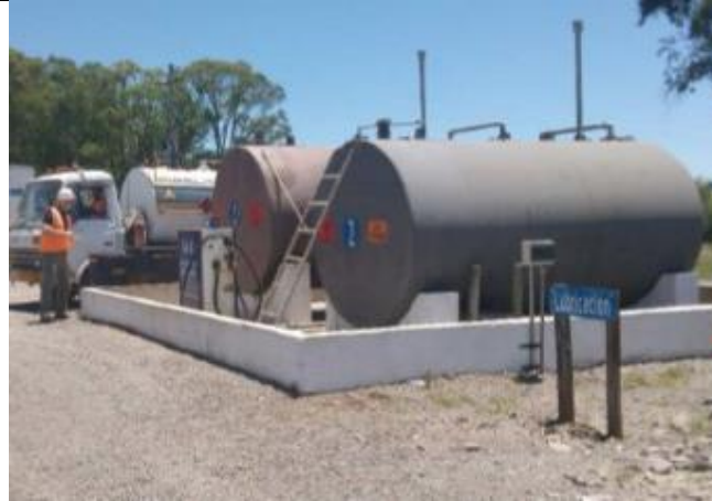
Figura 1 – Tanques de aceite lubricante con su correspondiente dique de contención de derrames.
