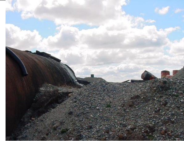
Figura 4 – Tanques con contención lateral del terreno sin asegurar la estanqueidad (2).
