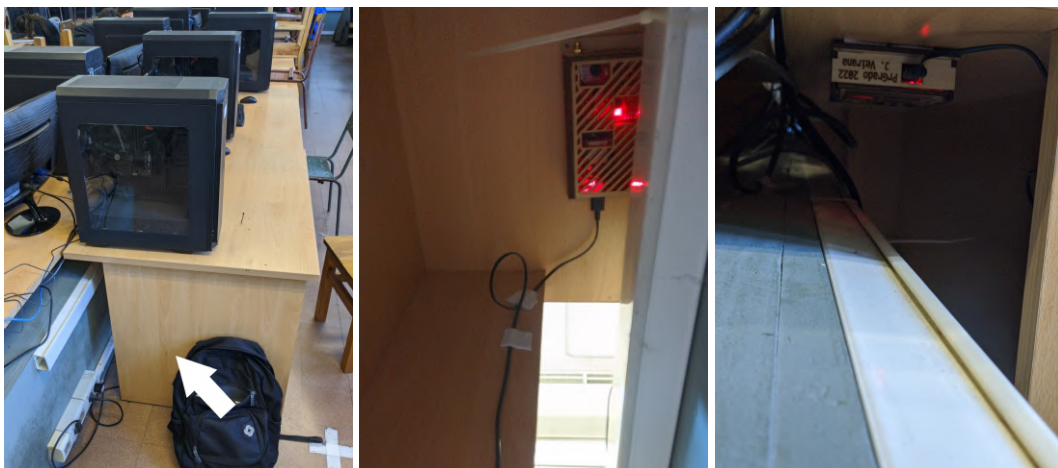
Figura 3.14: Sensor de calidad de aire instalado en el salón 312.
