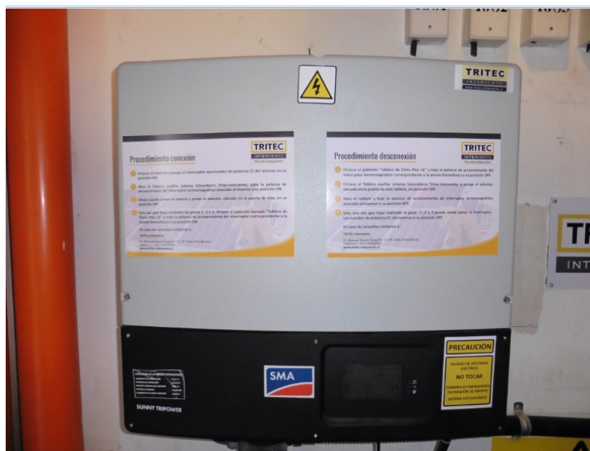
Figura 6.9: Fotografía de inversor con los procedimientos de conexión y desconexión.
