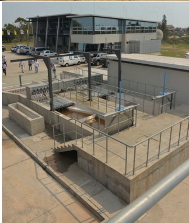
Ilustración 6: Planta de tratamiento de líquidos residuales en Salto Esta planta, inaugurada en octubre de 2019, beneficia a una población de 100.000 habitantes (Fuentes: https://970universal.com y https://www.presidencia.gub.uy )
