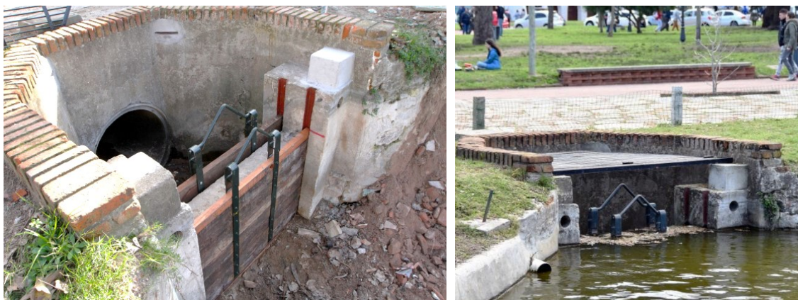
Ilustración 44: Compuertas de regulación del lago del Parque Rodó Vista durante vaciado para limpieza del lago, y con el lago ya en funcionamiento (Fuentes: izquierda http://www.montevideo.gub.uy/ y derecha foto propia)
