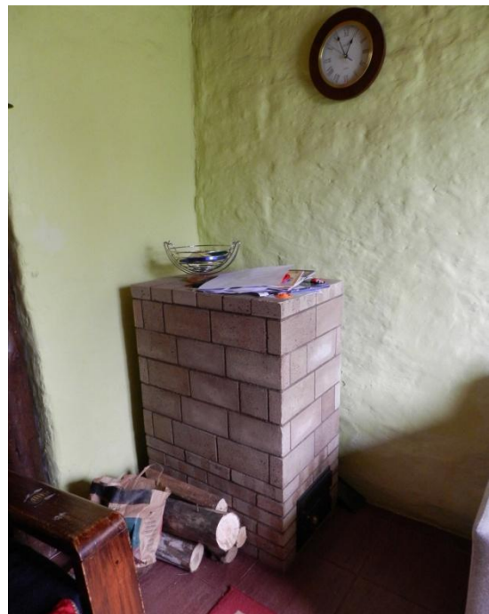
Estufa de biomasa. Llamadas Estufas Rusas. Se coloca una por vivienda. Diez estufas de biomasa que calientan prácticamente toda la vivienda.
