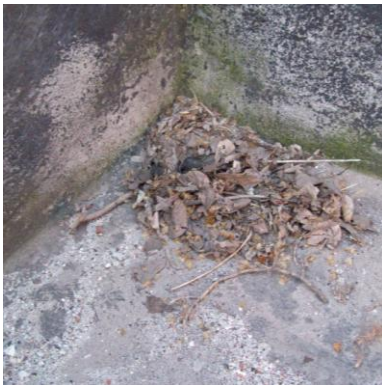
Fig. 6.3 c _ ramas y hojas obstruyen el caño de pluviales
