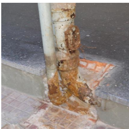
Fig. 3.1 e _ Cañería corroída debido a su ubicación en contrapisos húmedos
