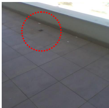
Fig. 6.3 a _ Desagüe de una terraza.
