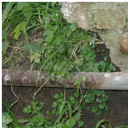
Fig. 3.1 b _ Cañería corroída debido a su ubicación en zonas húmedas
