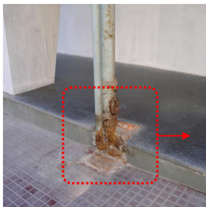
Fig. 3.1 d _ Cañería corroída debido a su ubicación en contrapisos húmedos
