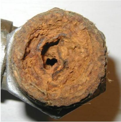
Fig. 1.3 a _ Tubería de hierro galvanizado presentando un nivel avanzado de incrustaciones calcáreas.
