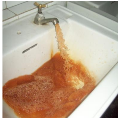
Fig. 3.1 a _ coloración del agua que transita por una tubería corroída
