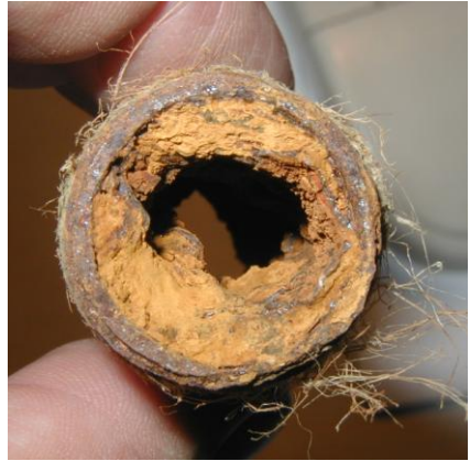
Fig. 1.3 b _ Extremo de tubería de hierro galvanizado presentando un nivel avanzado de incrustaciones calcáreas.
