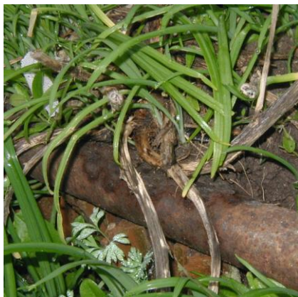
Fig. 3.1 c _ Cañería corroída debido a su ubicación en zonas húmedas
