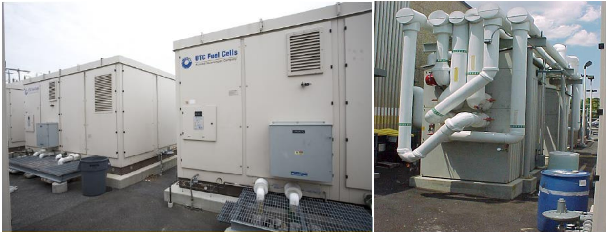
Figura 45 – Izq.: Instalación CHP en el Verizon Telecommunications Switching Center de Nueva York, conformada por 7 celdas de combustible tipo PAFC, de 200 kW cada una. Der.: en esa instalación, durante la temporada de verano, dos chillers de absorción de bromuro de litio aprovechan el calor desechado por las celdas de combustible y contribuyen con el 33% de la carga de refrigeración necesaria. (fuente: www1.eere.energy.gov )
