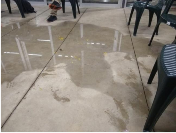
Figura 17. Agua de lluvia dentro del salón.
