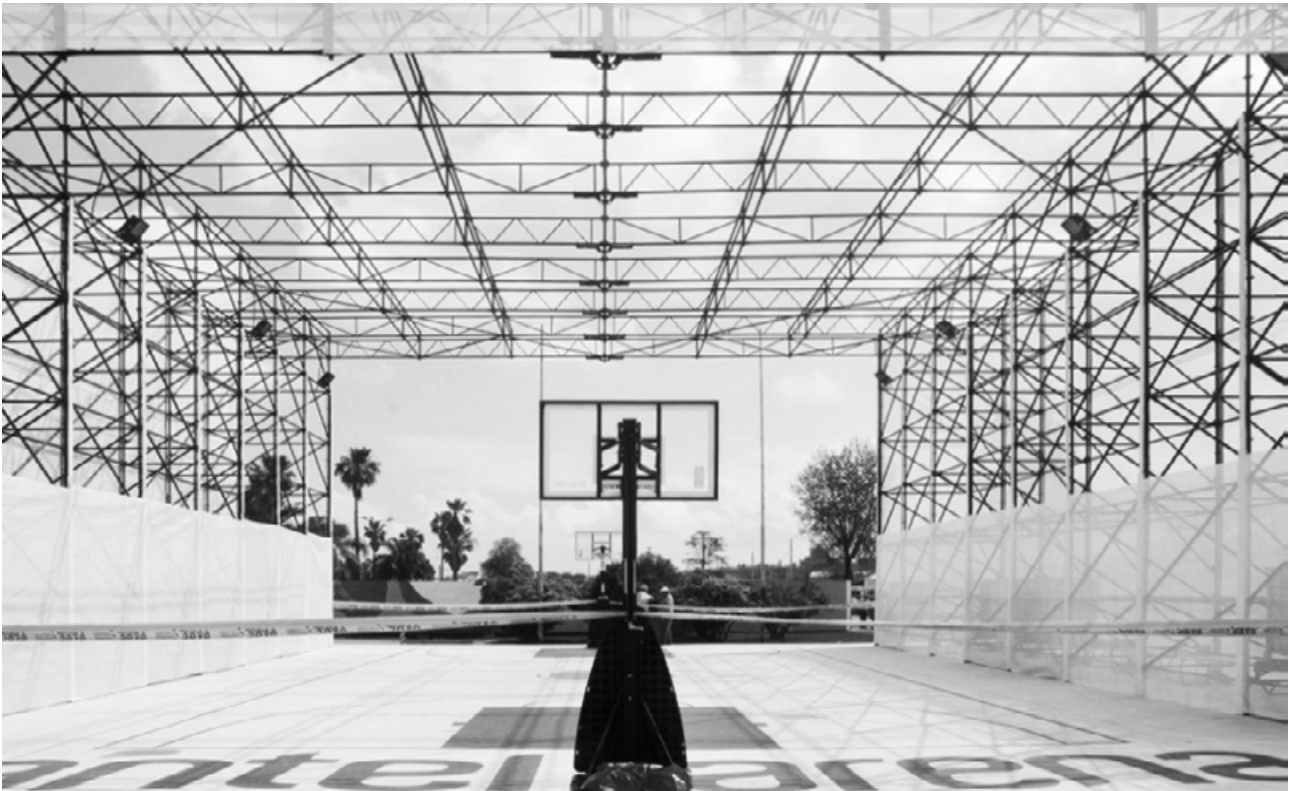
Espacio anexo al antel arena realizado en 2015 para contener una cancha techada durante el proceso de construcción. Sprechmann-Danza + MASA.
