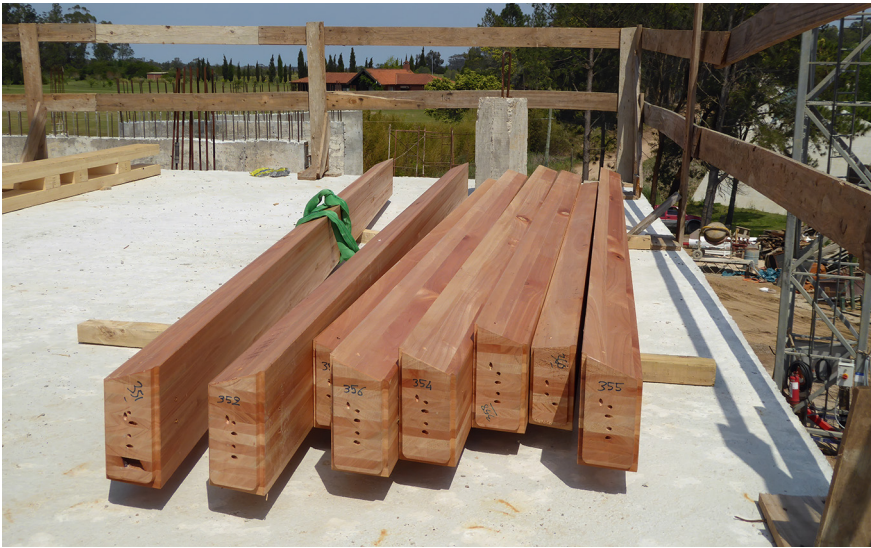
Figura A.5. Acopio de correas de MLE; se observa como todas tienen cortes distintos en las testas y en el canto superior
