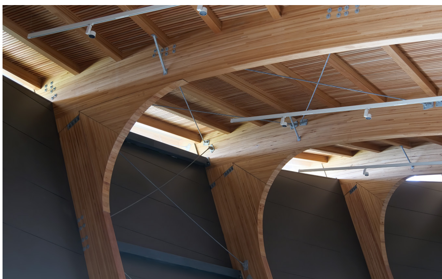
Figura A.19. Vano arriostrado mediante tensores metálicos y riostras de acero a nivel de fachada
