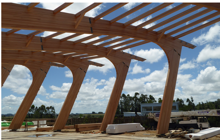
Figura A.9. Inclínación de los pilares de los pórticos; se observa que tienen colocados los complementos pero no los pilares «falsos»
