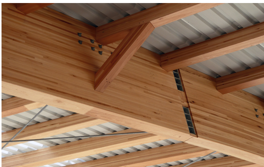
Figura A.13. Detalle de herraje Resix® en una de las uniones de transporte, y de una tornapunta de arriostramiento lateral torsional
