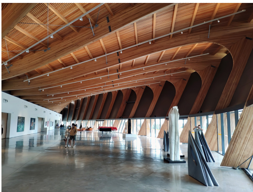
Figura 4.11. Fotografía del estado actual de la estructura, habiendo realizado el procedimiento recomendado —de lijar la madera, aplicar el ácido, limpiar la superficie y pintar con el protector de madera—
