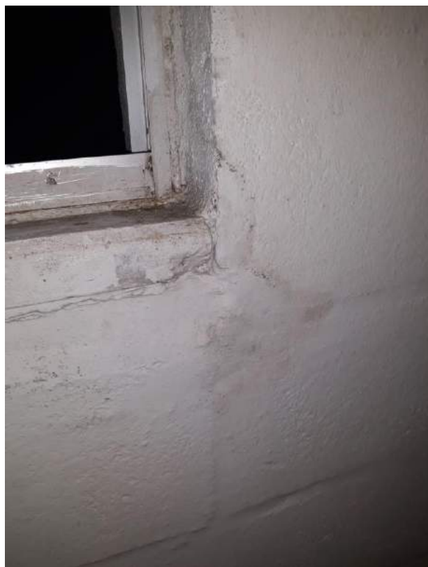
Relevamiento fotográfico de los reclamos por humedad Fuente: Comunidad el Apero
