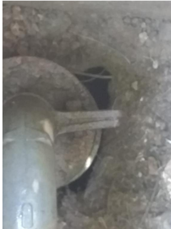
Fig. 68 Pozo con derrumbe lateral, capaz, generador de infiltración de posibles contaminantes directamente al agua subterránea. Falta de losa sanitaria. Pozo Campus Deportivo, Santa Rita.
