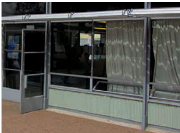
Figura 29. Vista de las ventanas rebatibles, al alcance de los niños, en la fachada norte del aula versión A, estado actual, escuela 47/108 de Capurro, Montevideo. Fuente: fotografía del autor, 2016.
