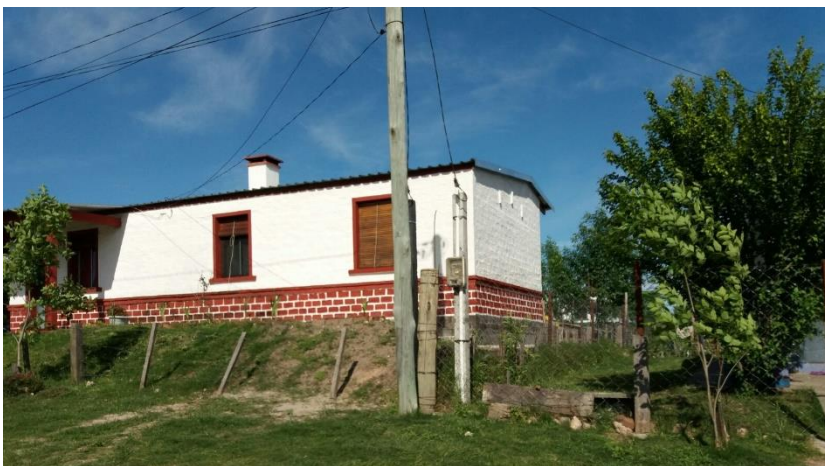
Imagen 11: Imagen panorámica de la vivienda que demuestra que no tiene cámara ventilada.
