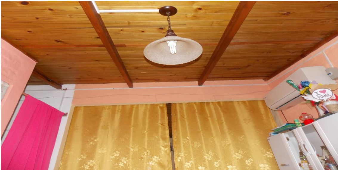
Imagen 10: Cielorraso de la vivienda tipo 3 de MEVIR.
