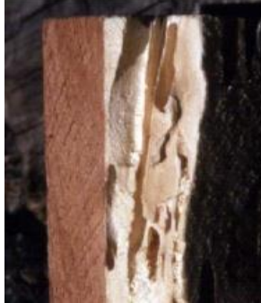
Figura 9. Trozo de madera atacado por Hylotrupes bajulus . 3
