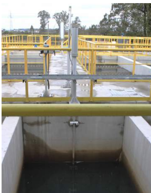
Figura 2.35: Batería de filtros
