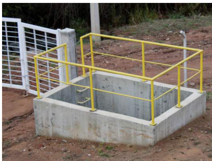
Figura 2.26: Cámara de acceso para la aplicación de carbón activado (En desuso)
