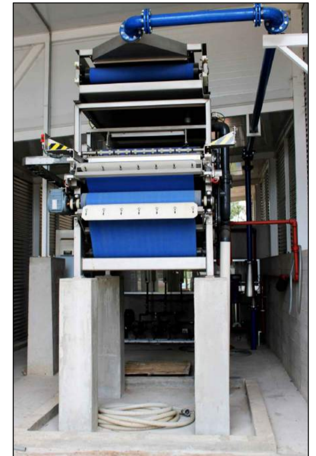
FOTOGRAFÍA FRONTAL FILTRO DE BANDAS
