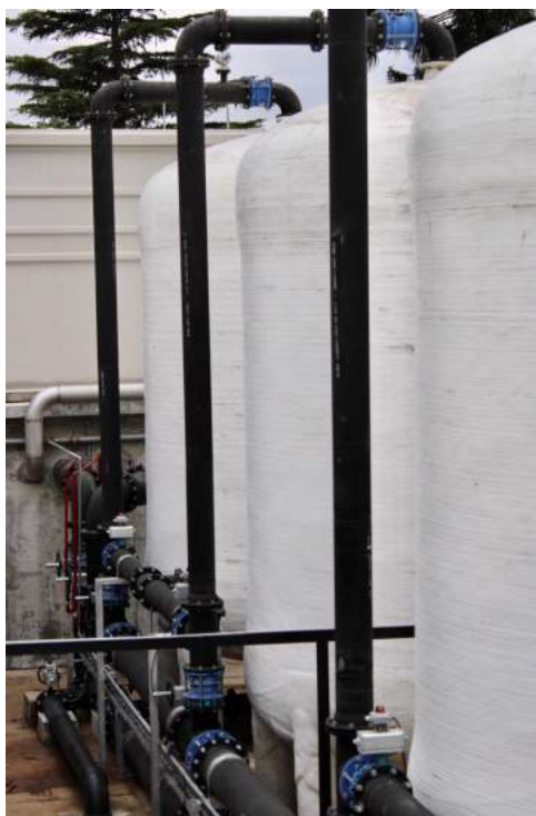
Figura 2.36: Unidades de filtro de carbón activado
