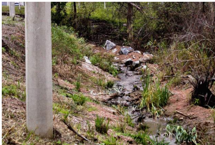
Figura 2.45: Descarga de lodos
