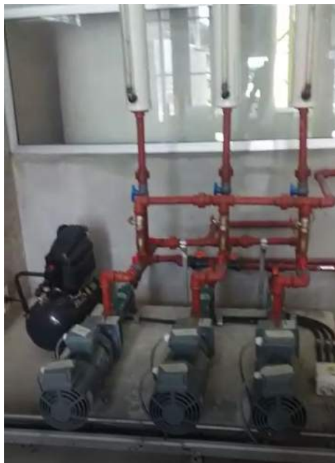
Figura 2.53: Bombas dosificadoras de polímero de lodo
