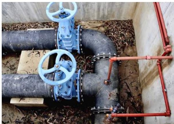
Figura 2.28: Puntos de inyección de coagulante en tubería de agua bruta
