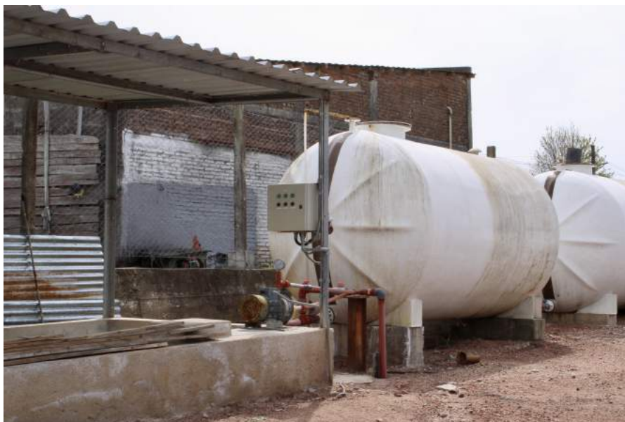
Figura 2.47: Tanques de sulfato de aluminio
