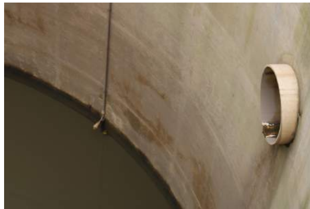
Figura 2.41: Interior de tanque ecualizador
