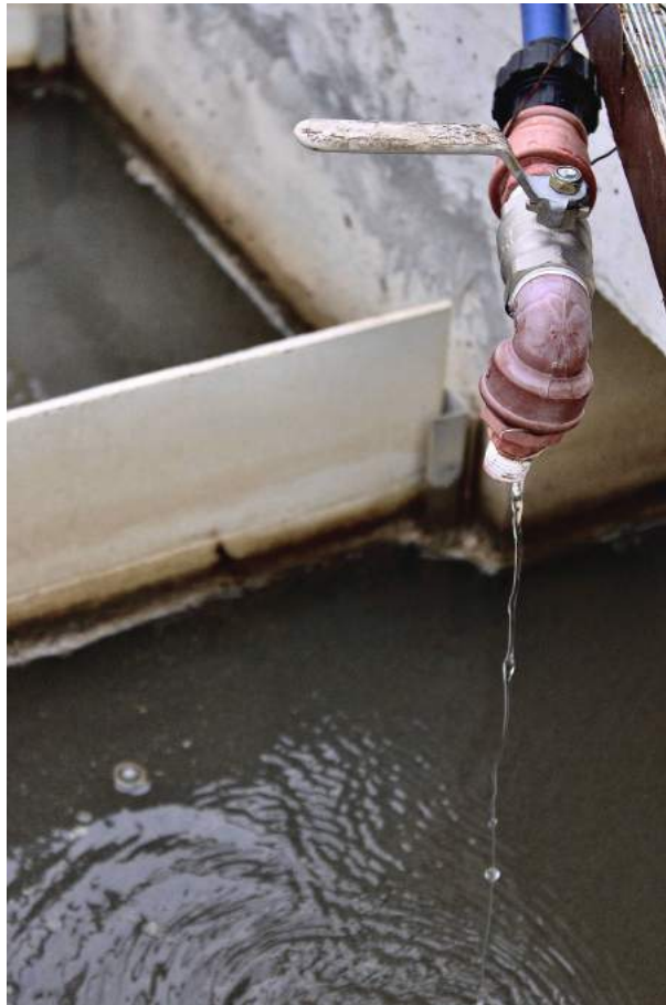
Figura 2.48: Aplicación de polielectrolito
