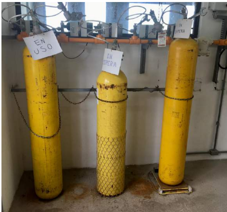
Figura 2.49: Cilindros de cloro gas
