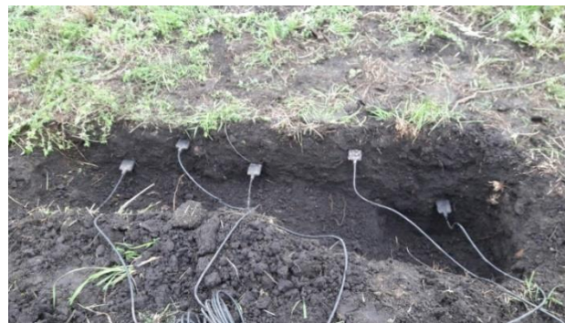
Figura 3-6: Sensores TDR instalados en la cuenca del río Yi.
