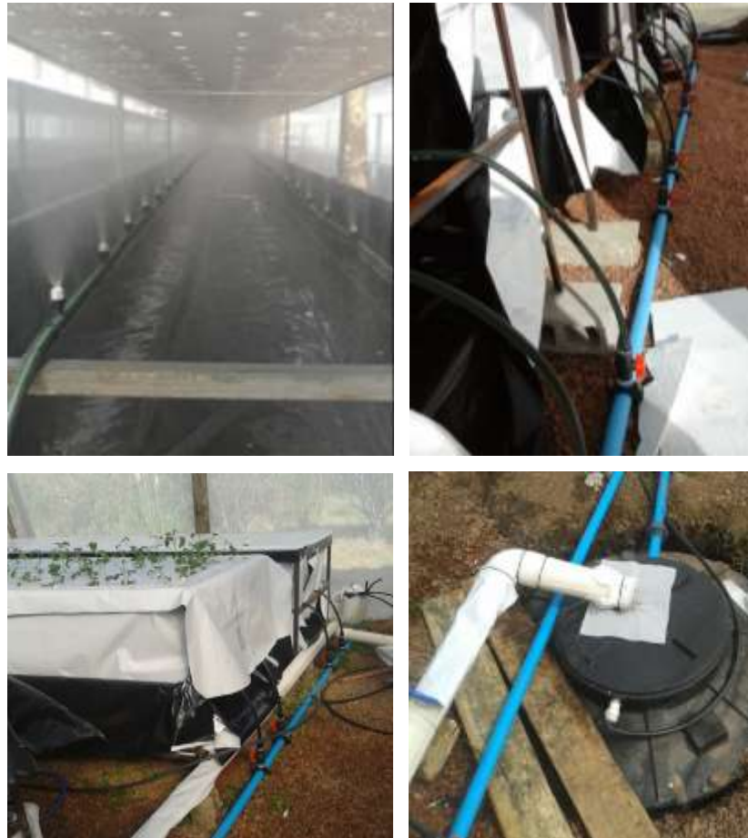
Líneas de microaspersores (arriba izq.); conexión de caños madre con líneas de microaspersores (arriba der.); extremo inferior de las mesas con canal de reciclaje y caño madre (abajo izq.); unión de canal de reciclaje con tanque de solución nutritiva (abajo der.).
