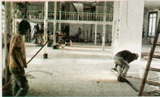
Gente en obra en la segunda planta del Centro de Eventos Plaza Fuerte-Sarandí a inaugurarse el 22 de octubre.
