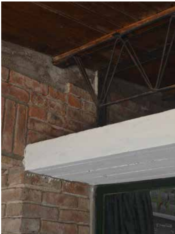
156. Detalle de viga reticulada y losa dintel. (Fuente: Foto Pedro Barrán en 2017)
