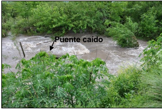
Figura 61 : Cañada en la zona del puente caído (1/11/2012)
