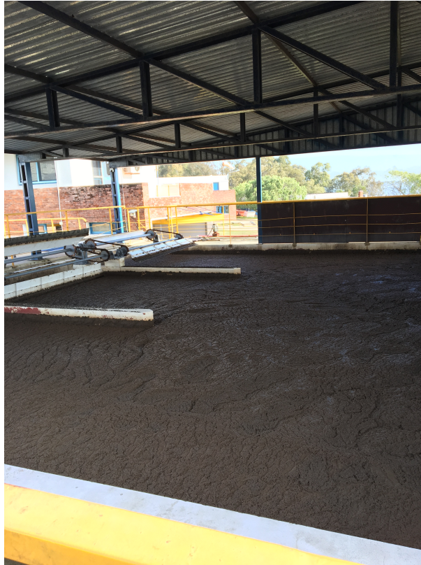
Figura 40: Unidad de flotación por aire disuelto.
