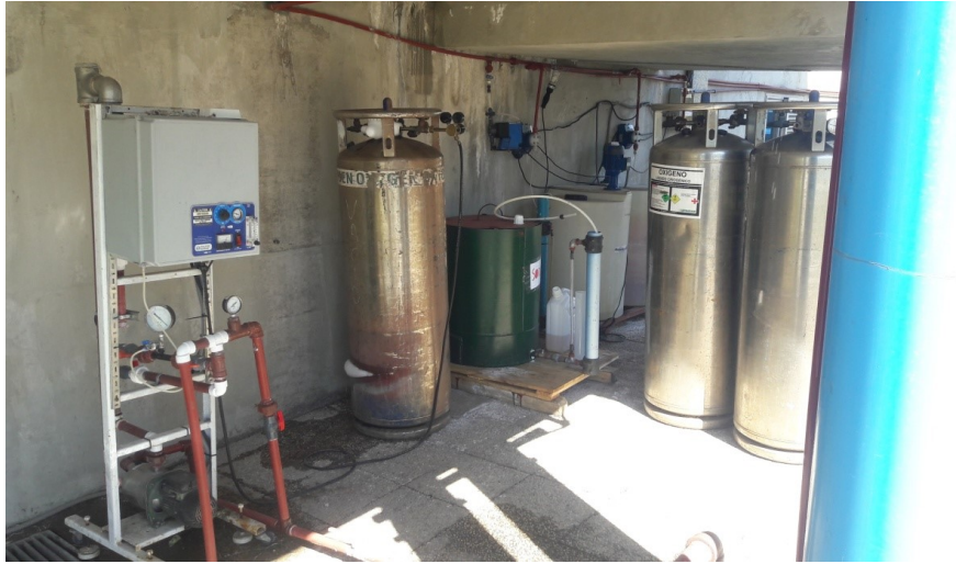
Figura 50: Equipo de generación de ozono piloto en Aguas Corrientes
