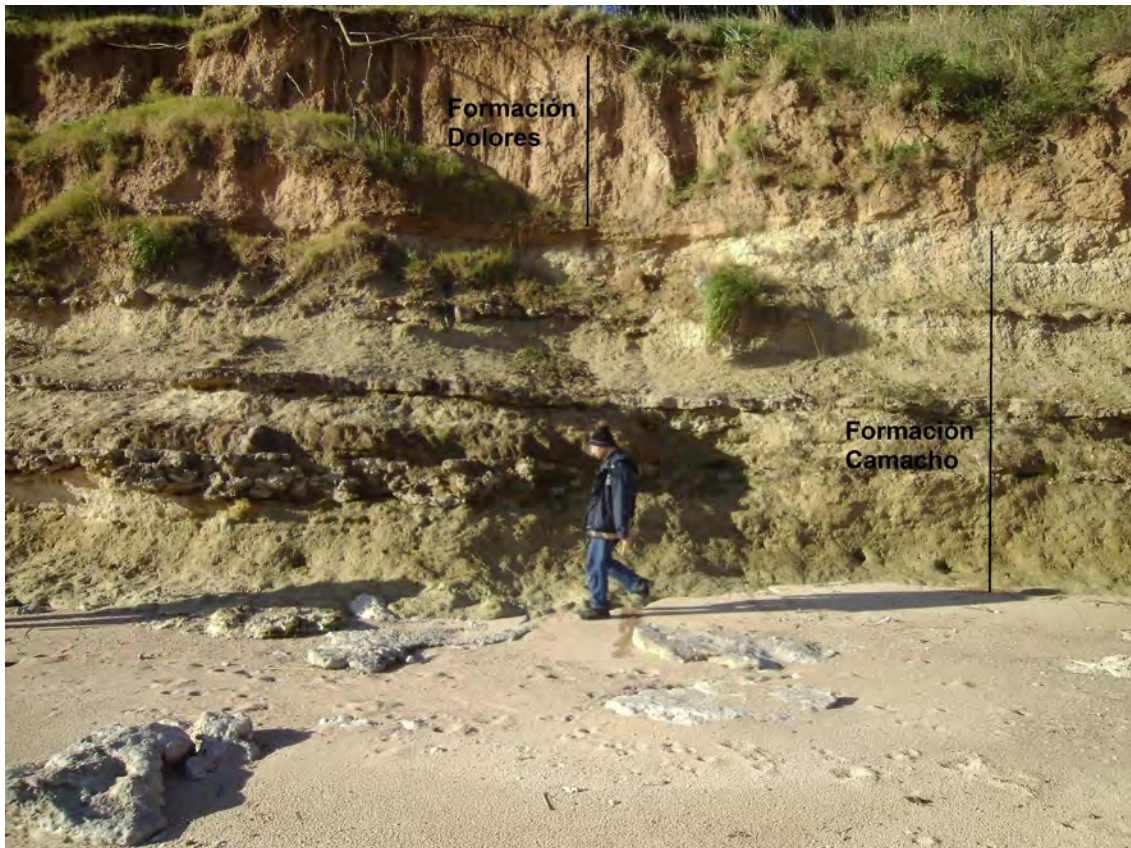
Figura 1: Barrancas de la playa del Arroyo El Caño (depto. de Colonia). Se indican las unidades aflorantes.
