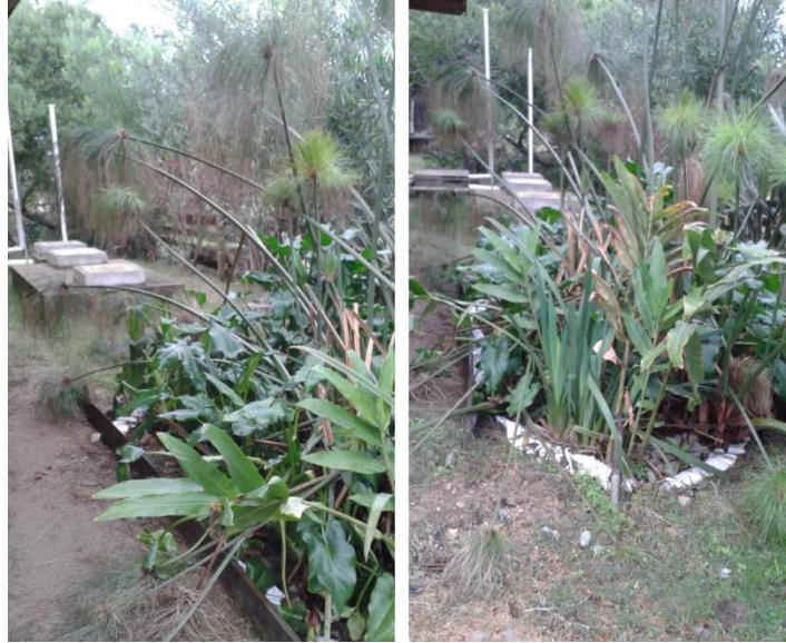
Figura 4. Sistema de fosas sépticas y de evaporación del efluente decantado.
