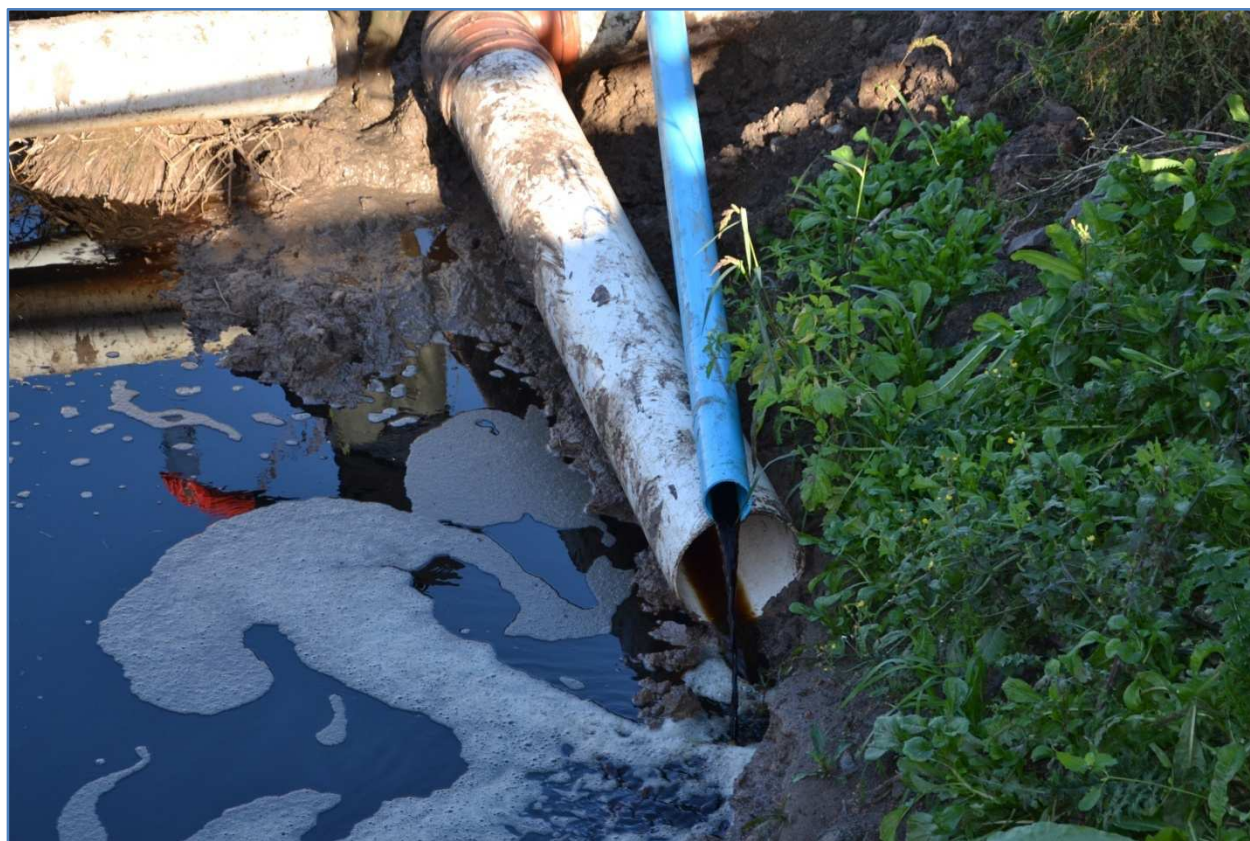
Fotografía 3-1 Fotografía de tuberías de conducción de lixiviados hacia "cámara 2"
