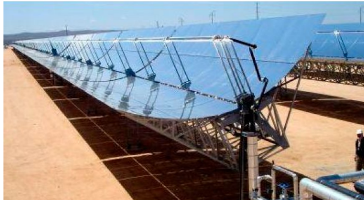
Figura 5: Instalación de canal parabólico, Minera El Tesoro, Chile. Fuente: Minera El Tesoro. Abengoa Solar [MPE, 2015].
