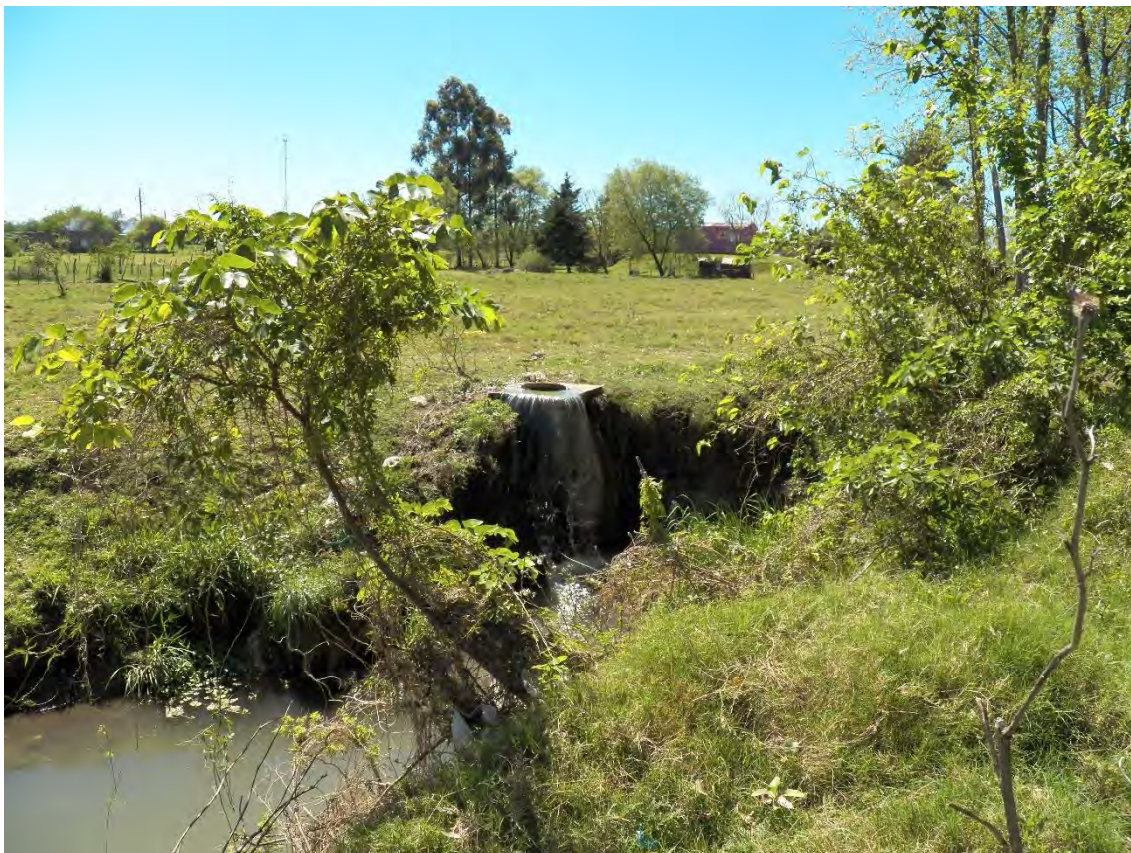
Fig. 14. Desborde de cámara de inspección del colector de saneamiento sobre el arroyo La Curtiembre a la altura del puente por calle Verocay.
