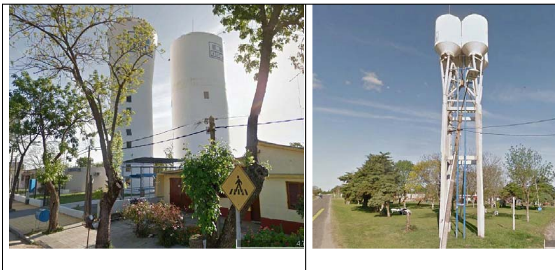
Ilustración 35: tanques de agua potable OSE
