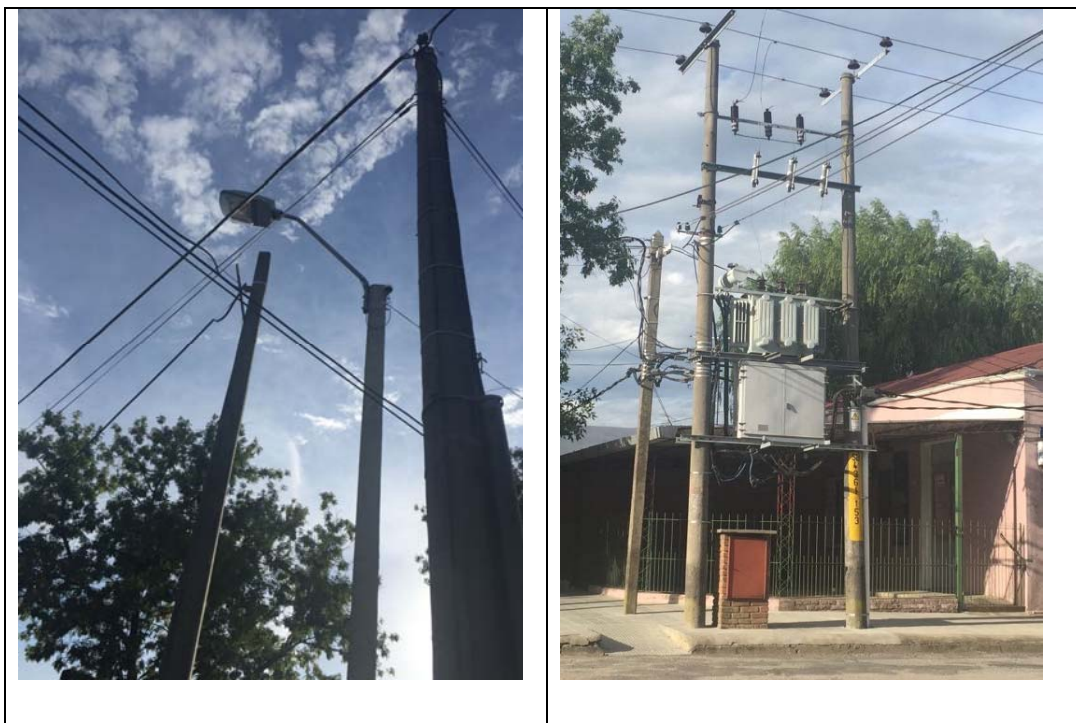
Ilustración 33: Alumbrado público urbano
