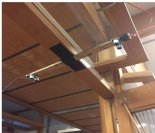
Figura 4.3: Sistema de sensores instalados en la parte superior del marco de una puerta.
