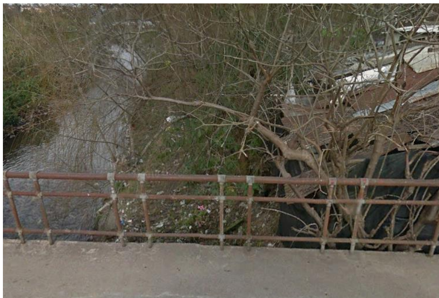
Figura 2.79 - Ejemplo de vivienda inundable para TR 2 ubicada en margen derecha del arroyo (Vista en Street View desde J. M. Silva).
