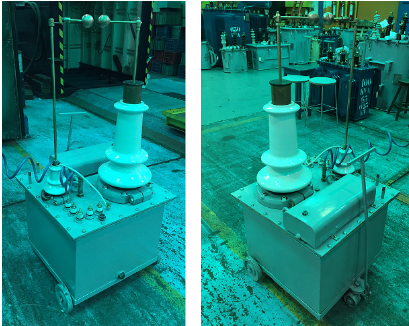
Figura 2.8: Imagen del transformador de ensayo luego de ser realizado el mantenimiento
