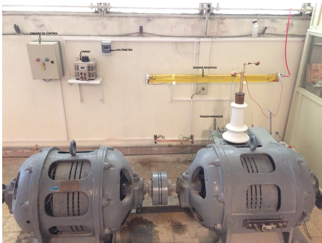
Figura 6.4: Vista frontal de la distribución final de equipos que conforman la fuente de media tensión.
