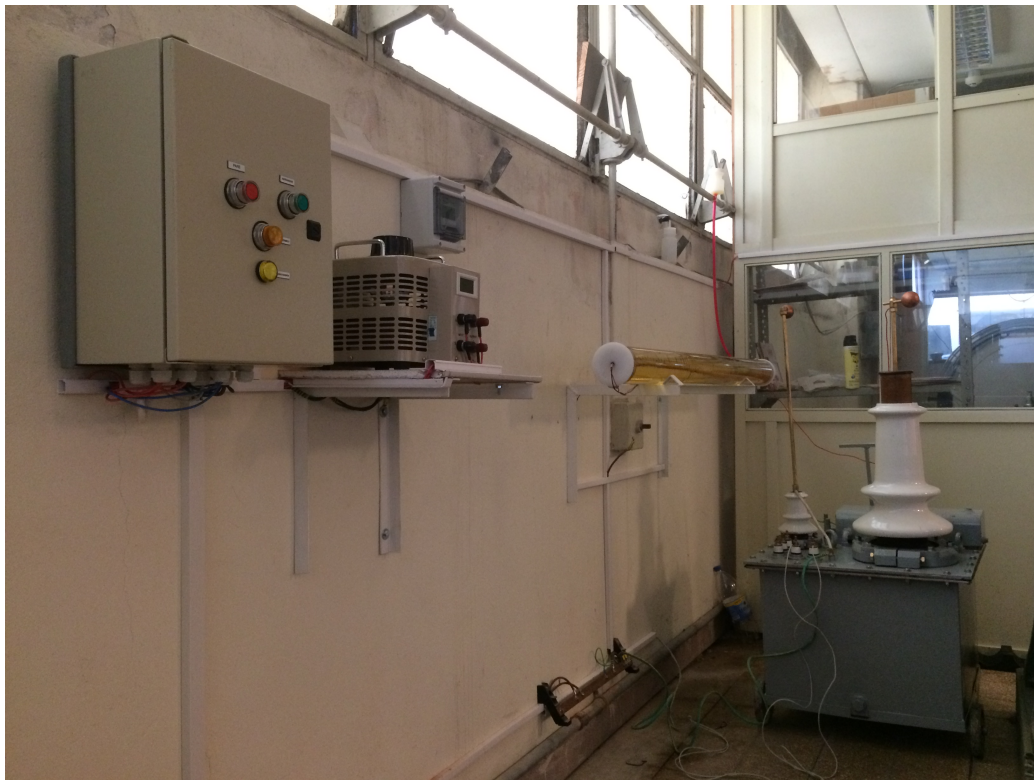
Figura 6.5: Vista lateral de la distribución final de equipos que conforman la fuente de media tensión.
