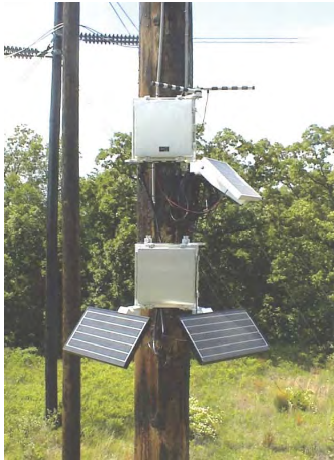
Figura 2.5: Equipos de comunicación utilizados para monitoreo online de las líneas de transmisión [16]
