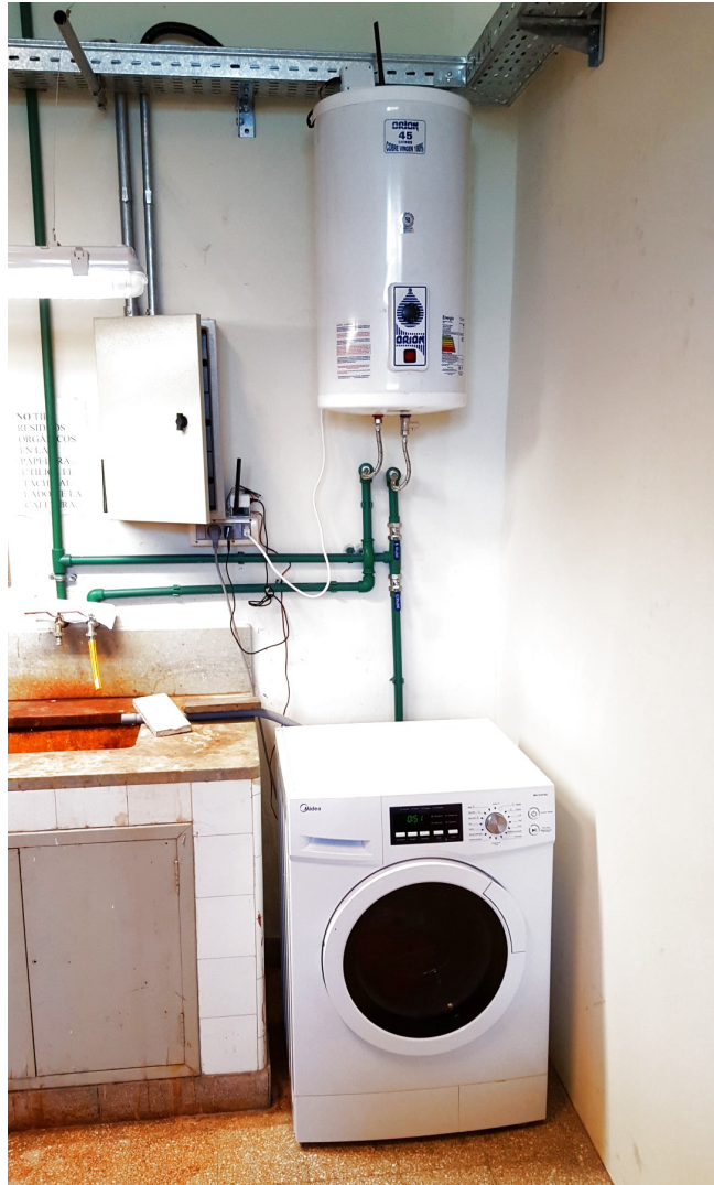
Figura 7.2: Equipamiento e instalación eléctrica del laboratorio de pruebas
