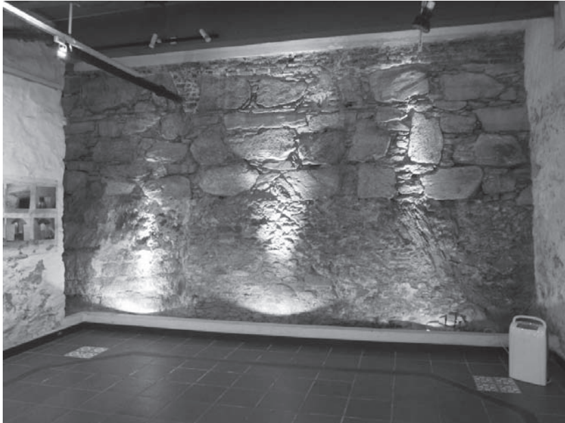
Figura 44. Tramo de la muralla de Montevideo en el Museo Al pie de la Muralla
