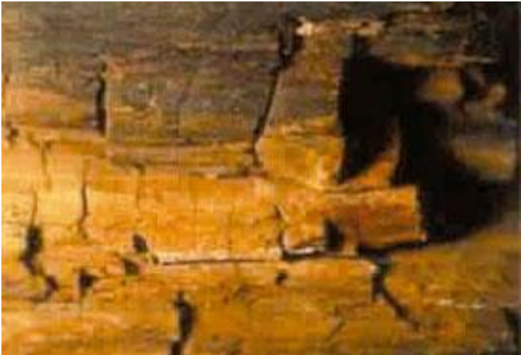
Pieza de madera atacada por hongo de pudrición. Fuente: Corporación Chilena de la Madera.
