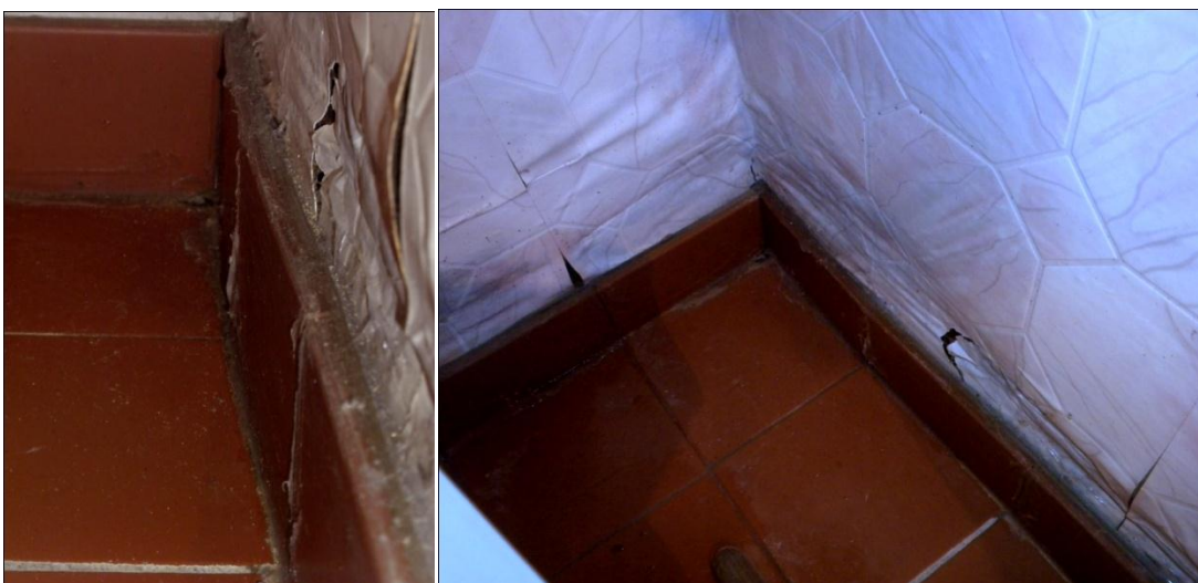
Fotos del encuentro entre el revestimiento y el zócalo en el baño.
