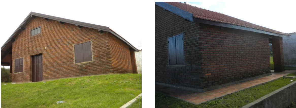
Fotos donde se aprecia la escasa ventilación en las fachadas de la vivienda.
