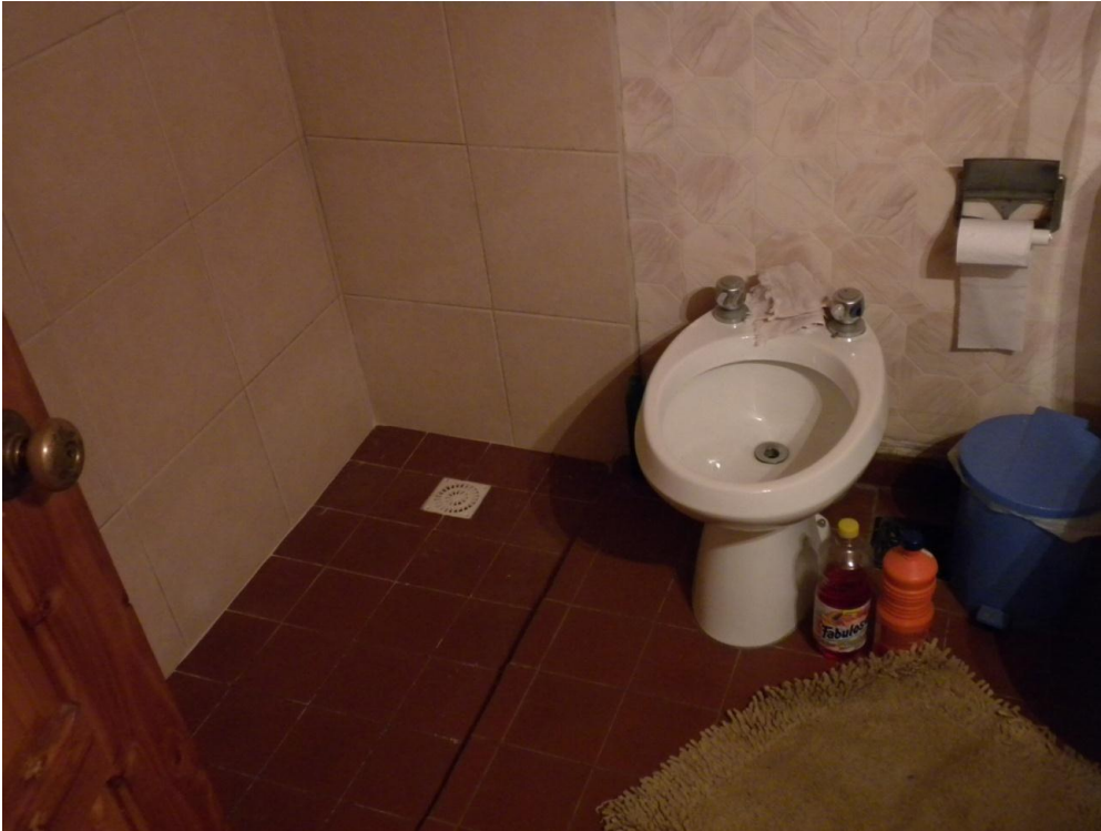
Foto del interior del baño, mostrando el encuentro entre los revestimientos.
