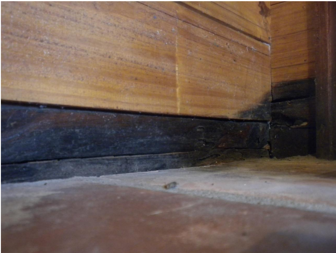
Foto de la primera hilera afectada por el contacto con el agua.
