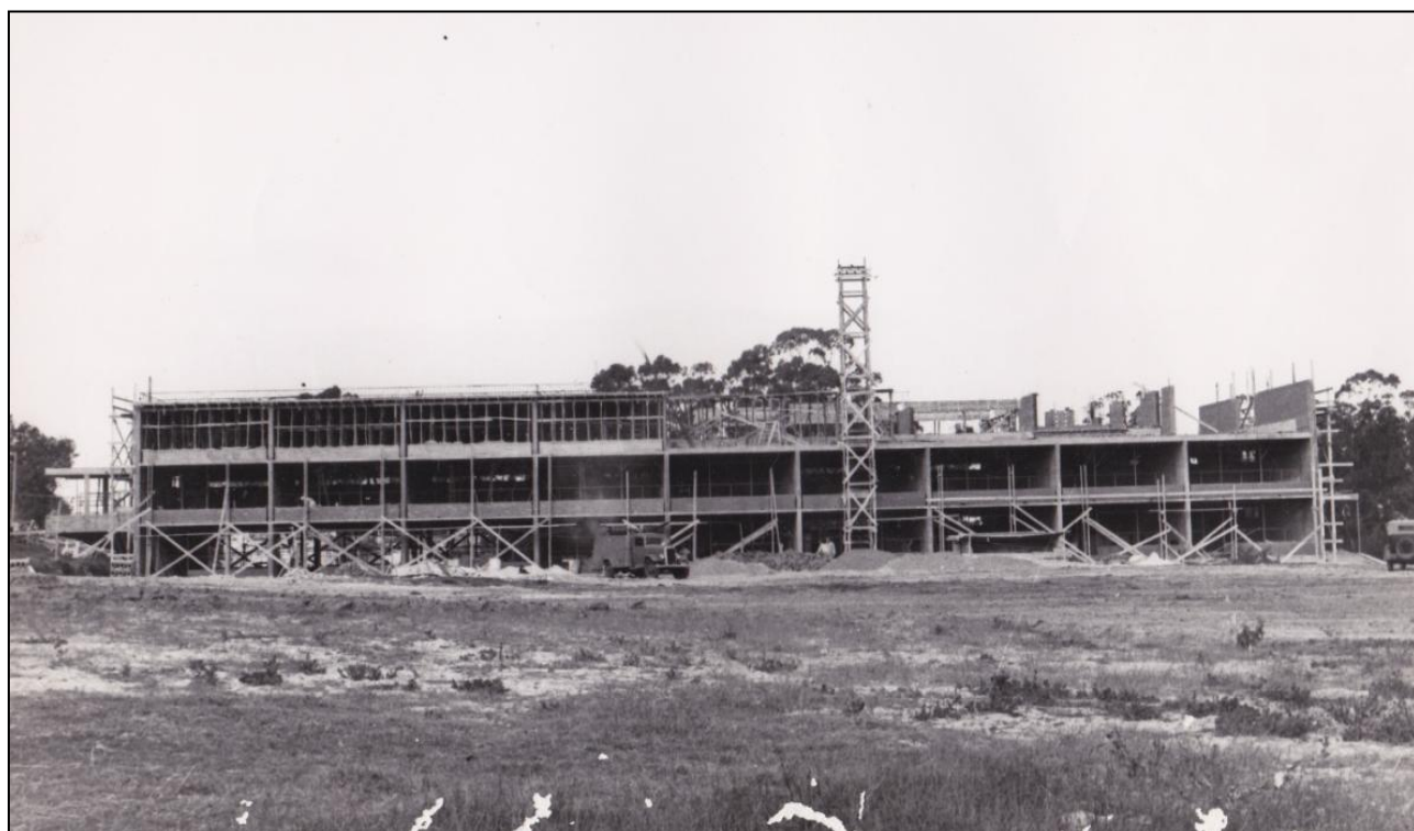
Colegio La Mennais. Obra, agosto de 1962. Fotografía general del edificio, apuntalamiento de losas de mitad del tercer nivel. En la otra mitad muros ya levantados. Archivo de los Hermanos Menesianos. Montevideo, Uruguay.
