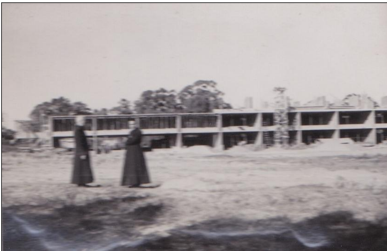
Colegio La Mennais. Obra, 4 de marzo de 1962. Fotografía general del edificio. Construcción del segundo nivel. Archivo de los Hermanos Mensesianos. Montevideo, Uruguay.
