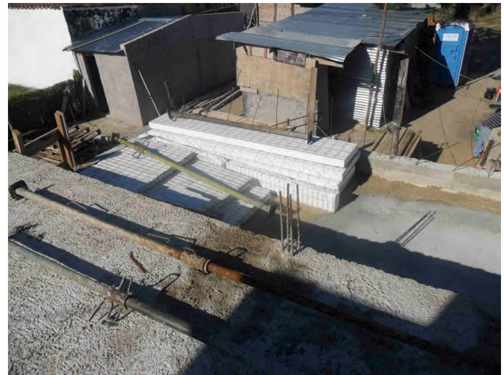
SECTOR ACOPIO DE MATERIALES Y HERRAMIENTAS
