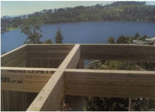
Figura 15- Tipo de unión [Fuente: Ricardo Hempel. (2008). "Sistema Constructivo de Madera Solida". Chile : Universidad del BIO BIO.]
