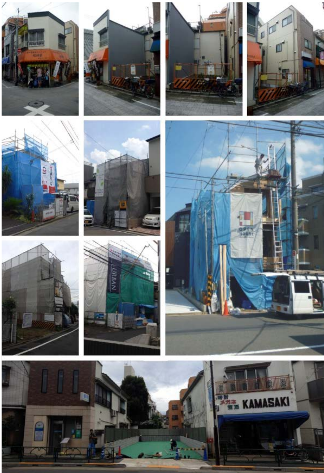
Obras, edificios en proceso de demolición y predios vacantes en Nakano, Tokio. Fotografías tomadas por el autor, 2016.
