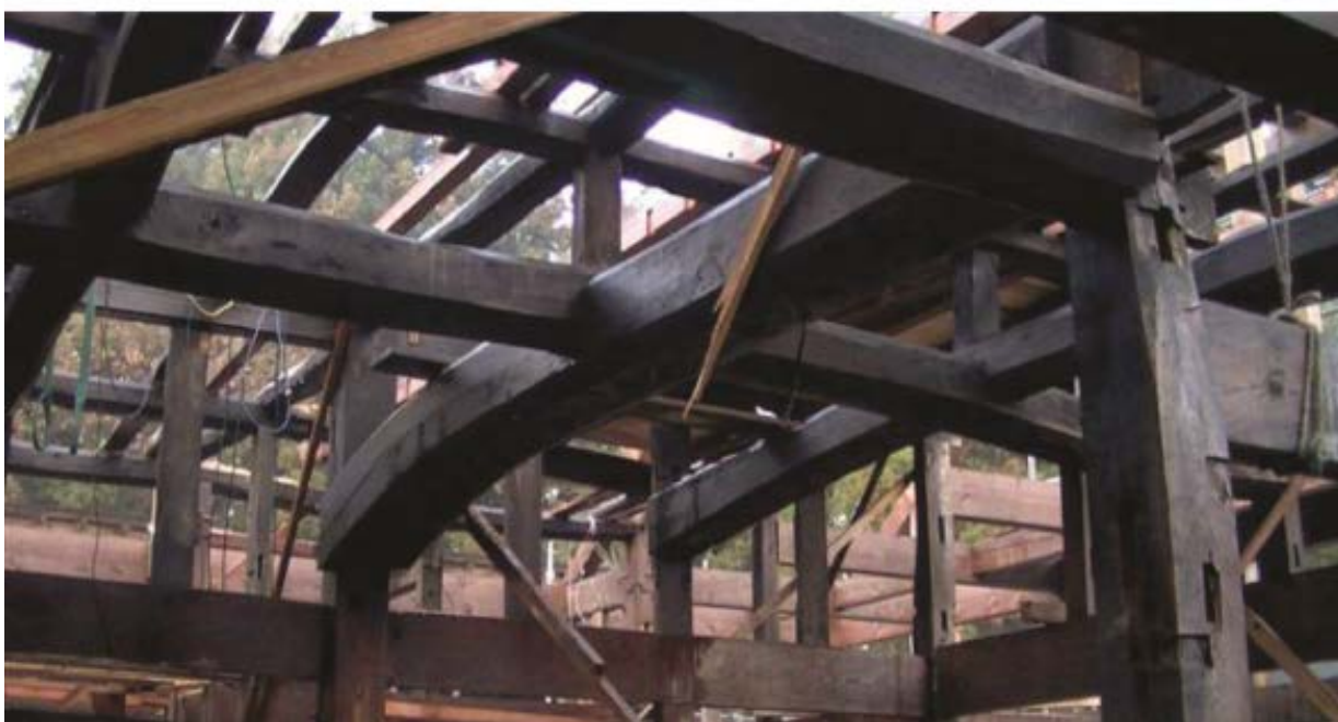
La cubierta se construye apoyando vigas sobre vigas con una reducción de las luces a salvar. Fotografías tomadas de flickr.com, 2015.
