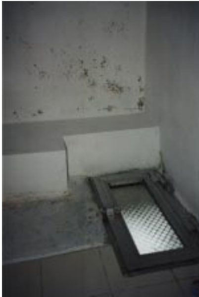
Fig.3.6- Patología de condensación en baños.
