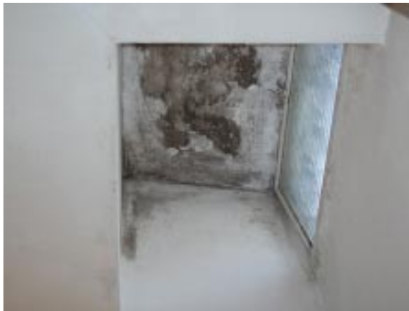
Fig.3.7-Condensaciones en cielorraso de ducto de un baño.
