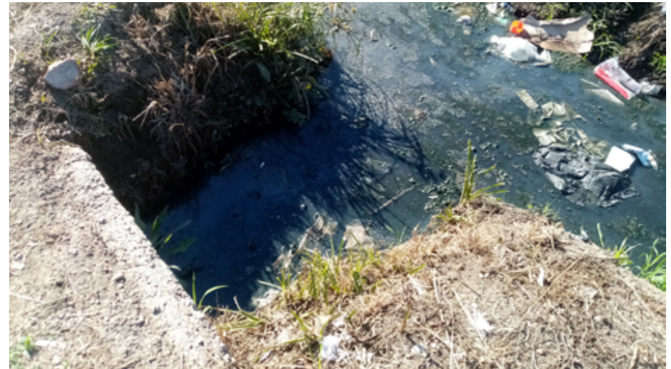
Fotografía 17. Zanjas que llegan a la cuneta. Barrio Maracaná Norte, mayo de 2020. Elaboración propia.
