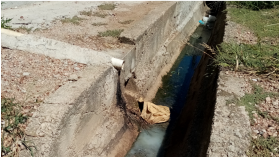
Fotografía 16. Caños salientes en la cuneta. Barrio Maracaná Norte, mayo de 2020. Elaboración propia.
